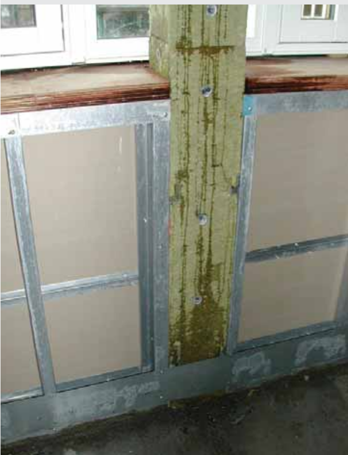
REGNVANN: Oppfukning av bygningsmaterialer i byggefasen. Dårlig midlertidig tetting av utettheter og åpninger i fasade under oppføring har her ført til at regnvann har fuktet opp konstruksjonene.
