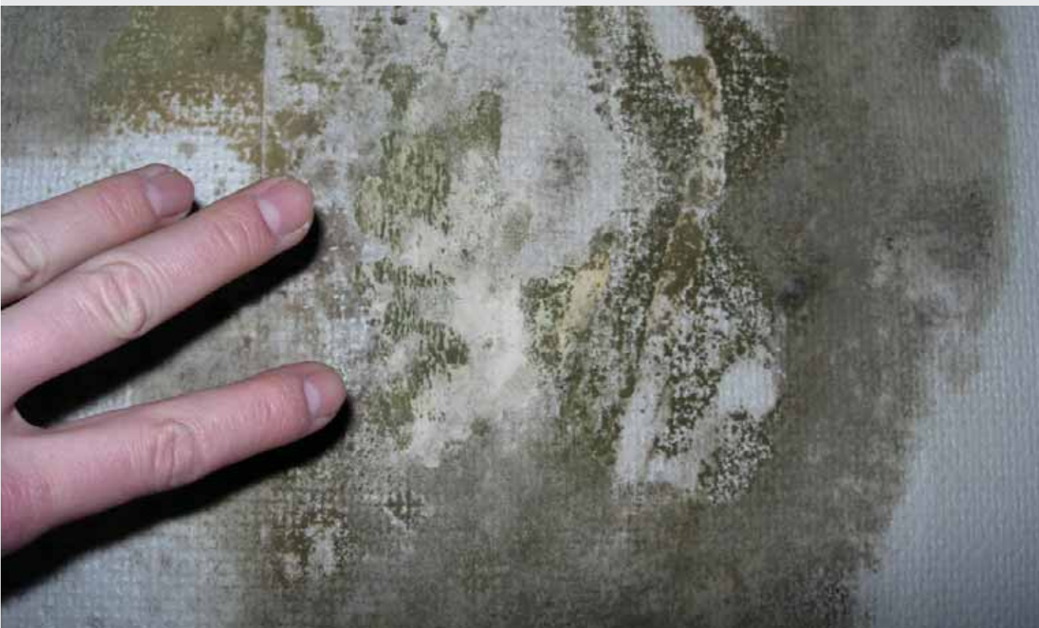
MUGGVEKST: Omfattende muggvekst på innvendig veggoverflate i en eldre yttervegg av massivtegl. Fasaden er utvendig rehabilitert med feil malingstype som delvis flaket av etter kort tid. Dette førte (sammen med enkelte andre årsaker) til at fasaden tok opp svært mye nedbørvann, og at muggvekst kunne etablere seg på innvendig overflate.
