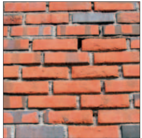
FIGUR 3 Veggparti med forvitrede mørtelfuger og dermed stor fuktinntrenging. I tillegg har veggpartiet noe frostskaadet tegl.
