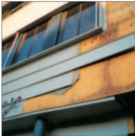
FIGUR 2 Båndkledd fasade med fuktskader knyttet til regninntrengning i fasaden og mangelfull drenering og lufting.
