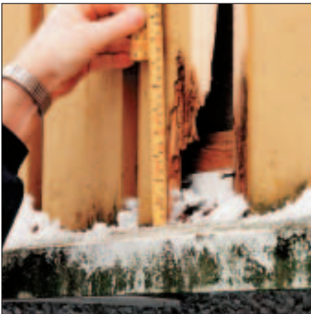
FIGUR 1 Kraftig råte observert ca. 15-20 cm opp på stående kledning. Bildet viser også at vannbrettbeslaget ikke er avsluttet inn under veggens vindspærresjikt. Eventuell fuktighet på vindspærren kan dermed finne veien ned i underliggende konstruksjoner.
