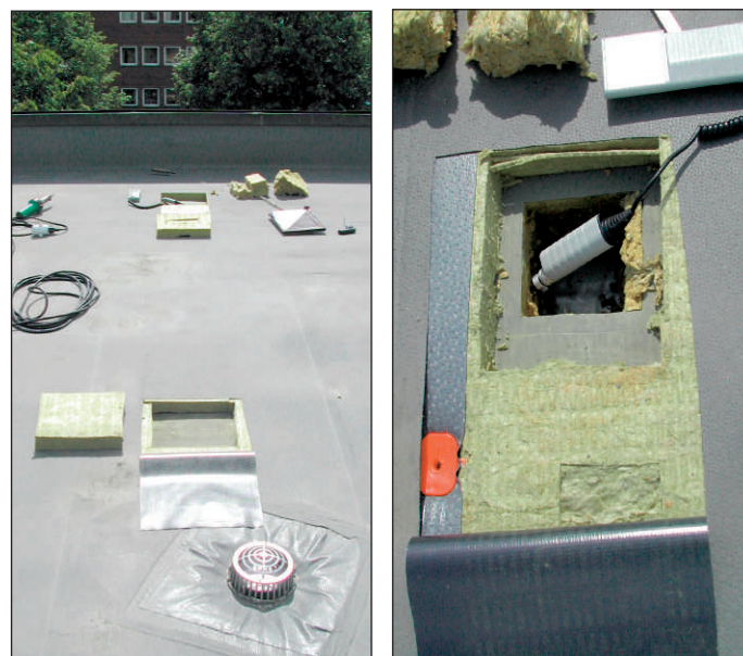
Figur 1: Bilder fra ett av takene etter at det er åpnet for observasjoner, prøvetaking og målinger
